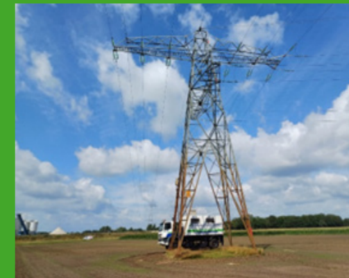
Foto 14: coating op hoogspanningsmast (chrom-6)
