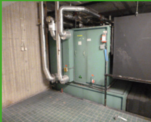
Foto 9: groene coating op installatie (chrom-6)
