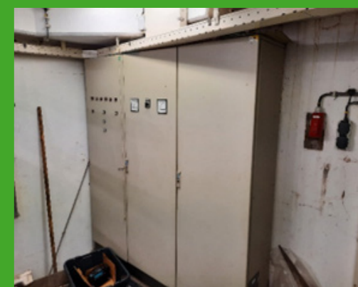
Foto 2: coating op meet- en schakelkast (chroom-6)
