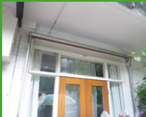
Foto 26: constructiebalk boven kozijn (chrom 6 en lood)
