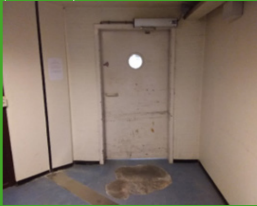
Foto 23: coating op stalen kozijn (chrom-6)
