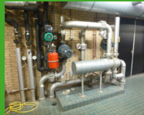
Foto 13: coating op leidingwerk (chrom-6)
