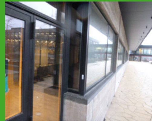
Foto 11: coating op stalen kozijnen (chrom-6)
