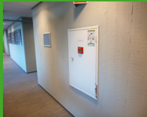
Foto 6: coating op stalen deur (chrom-6)
