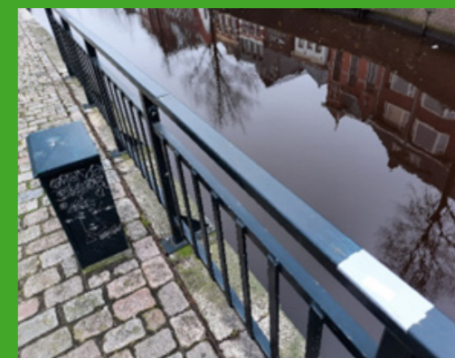
Foto 1: coating op brugreling (chroom-6)
