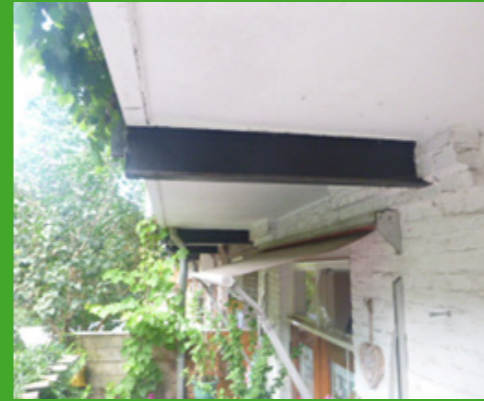
Foto 27: stalen draagbalk balkon (chrom-6 en lood)
